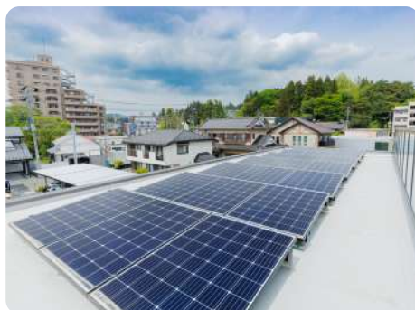
太陽光パネル
